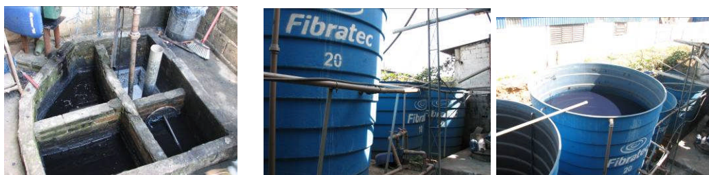
Figura 2 - Receptor de efluentes e tanques para tratamento químico (LIMA, 2008).
